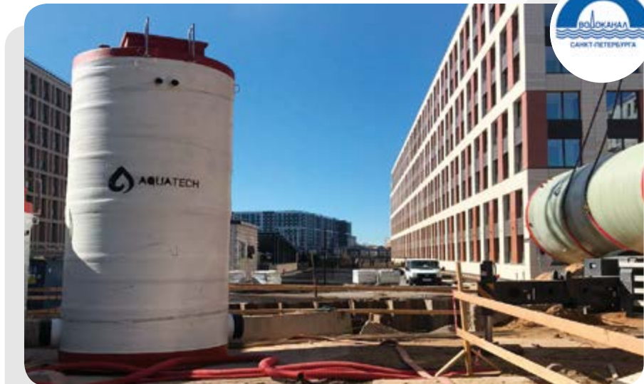
Объект: Санкт-Петербург, Петровский пр., 26 Оборудование: Канализационная насосная станция марки «АКВАТЕХ»
