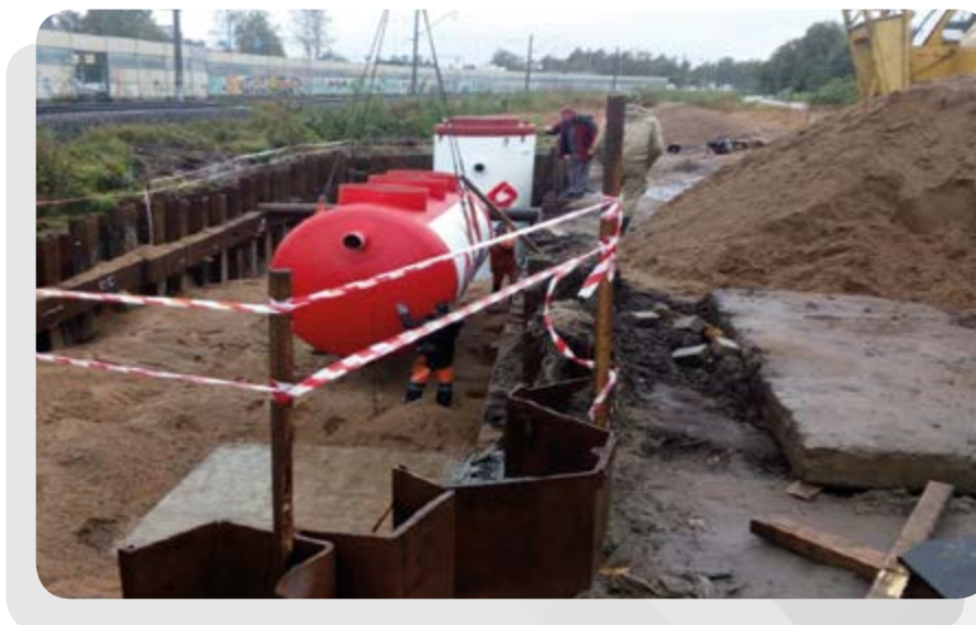
Объект: г. Санкт-Петербург, ул. Южная Оборудование: Ливневые очистные сооружения марки «АКВАТЕХ»
