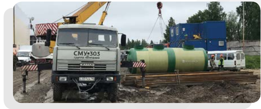
Объект: г. Петрозаводск, Петрозаводское президентское кадетское училище Оборудование: Канализационная насосная станция марки «AKVATEX» и ливневые очистные сооружения марки «AKVATEX»
