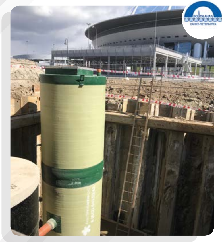
Объект: «Зенит Арена» г. Санкт-Петербург, Футбольная аллея, 1 Оборудование: Канализационная насосная станция марки «AKVATEX»
