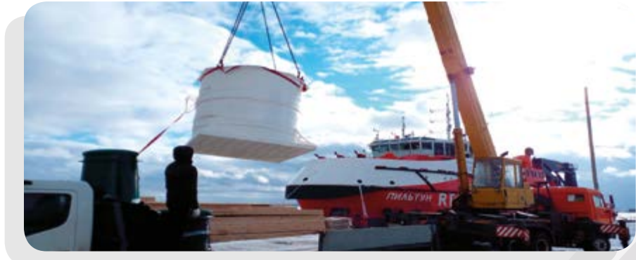
Объект: форт Кроншлот Оборудование: ЛОС хозяйственно бытового стока «АКВАТЕХ»
