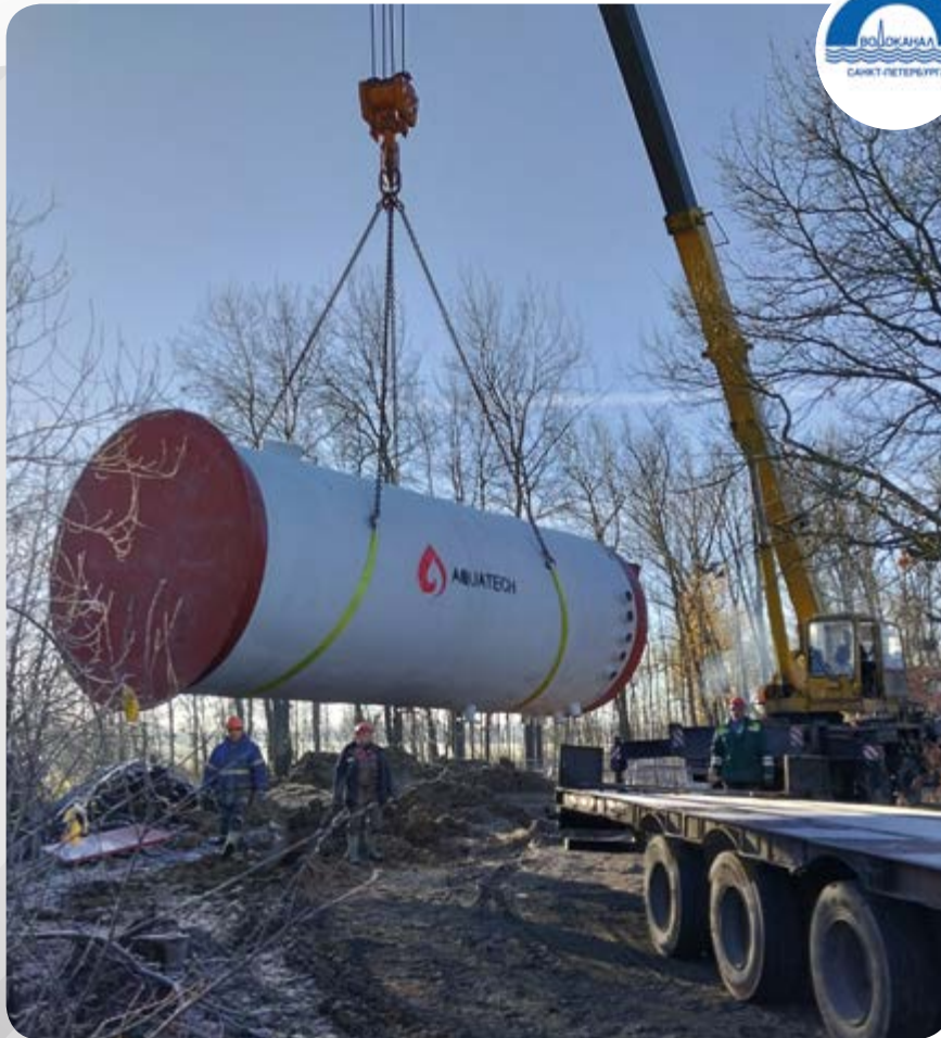
Объект: г. Санкт-Петербург, пос. Петро-Славянка, Бугровая ул., д. 26 Оборудование: Многокорпусные насосные станции хозяйственно-бытовых вод – 13 шт., Канализационная насосная станция «АКВАТЕХ КНС» – 13 шт., колодцы под шкафы управления – 13 шт.
